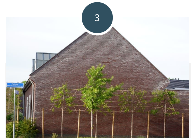
Efflorescences dites tardives/secondaires (gypsification ou grisonnement)
