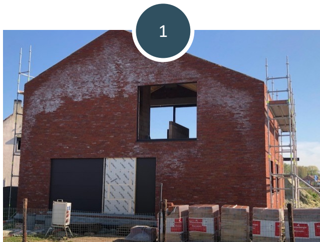
Efflorescences de sel dites précoces/primaires
